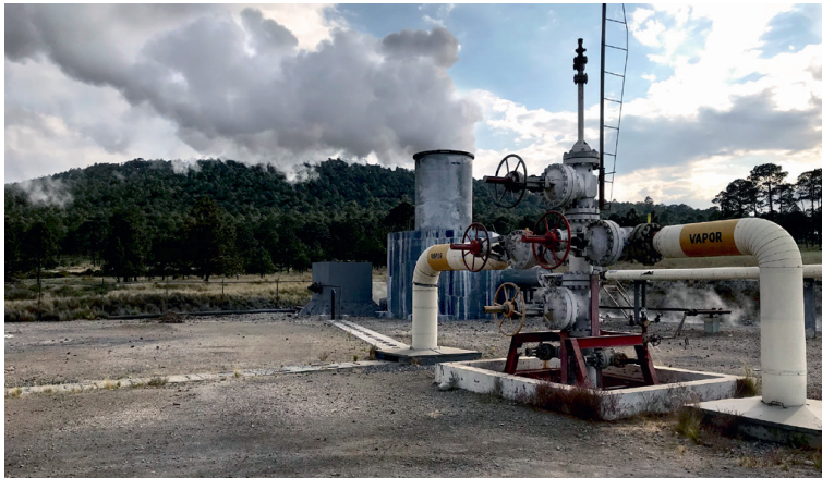
Abb. 1: Bohrung im Los Humeros Geothermiefeld, Mexiko. Die Förderbohrung H49 erreicht eine Tiefe von über 2000 m und wird zusammen mit 30 anderen Bohrungen zur Stromerzeugung genutzt. Das Los Humeros Geothermiekraftwerk hat eine installierte Leistung von ~95 MWe (Megawatt elektrisch). Foto: Egbert Jolie
